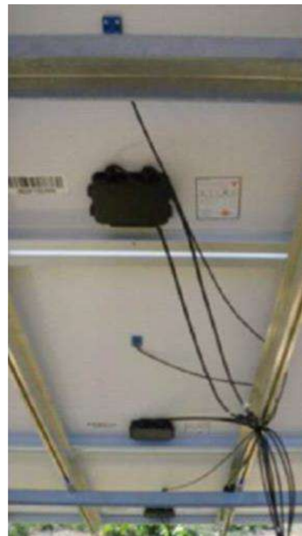
Figure 54 : Câbles des modules
